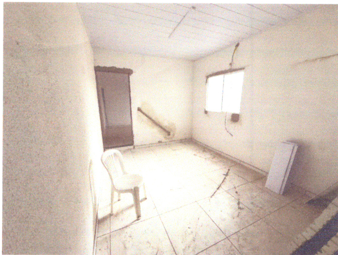
JANELA, REVESTIMENTO CERÂMICO
